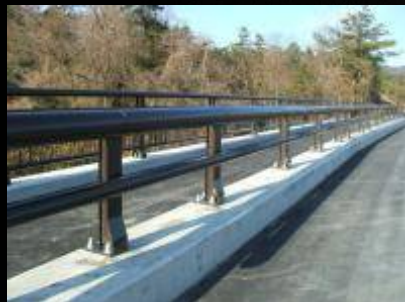
歩車道境界に設置した橋梁用ビーム型防護柵
